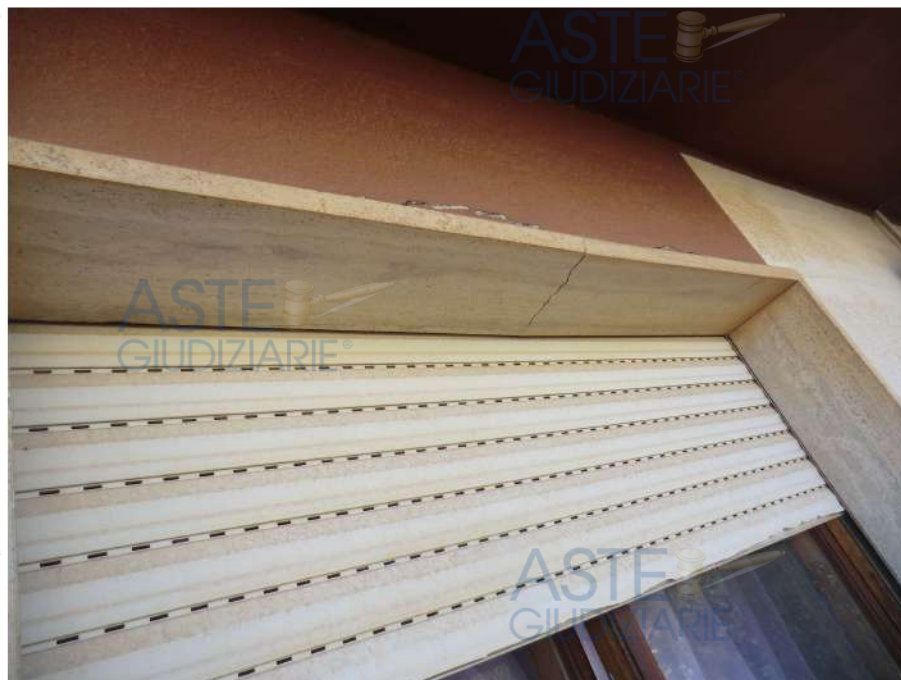
Foto n.23. Via Marmilla n.6- Iglesias. Avvolgibili in pvc e lastre in marmo danneggiate.
