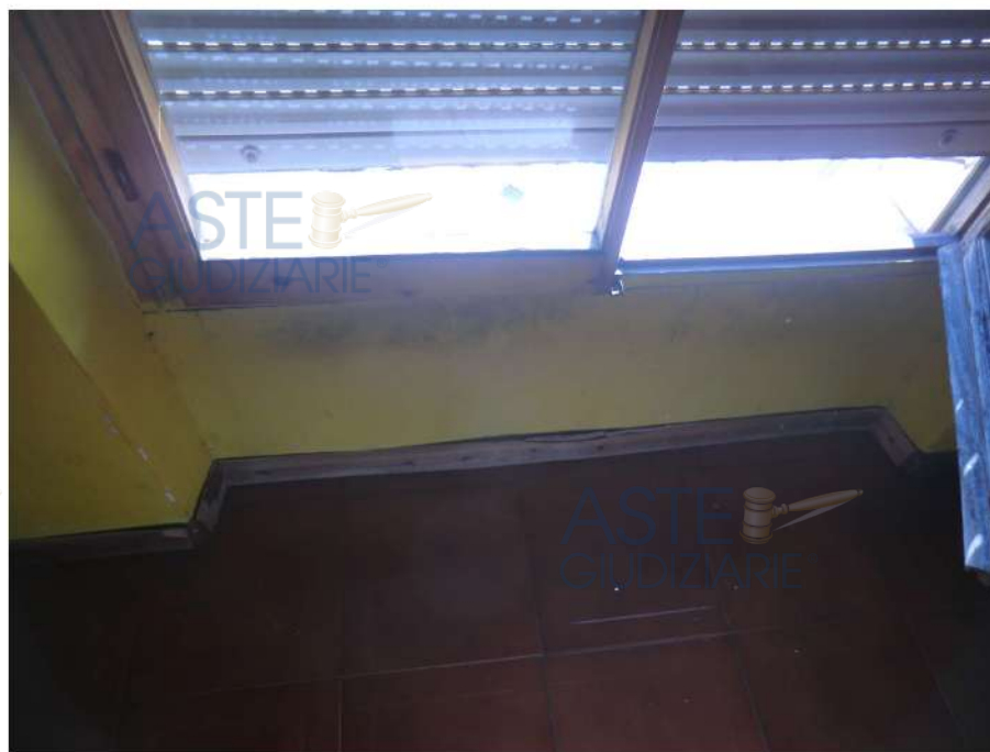
Foto n.22. Via Marmilla n.6- Iglesias. Battiscopa in legno danneggiato.
