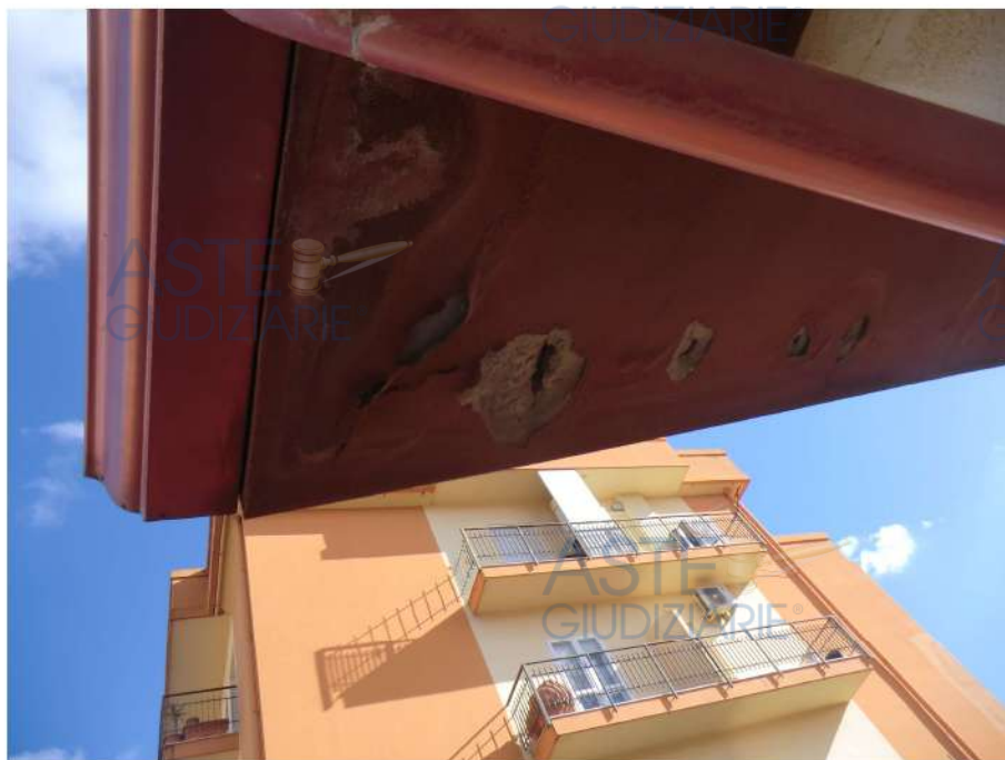
Foto n.27. Via Marmilla n.6- Iglesias. Sporto del tetto. Sono visibili i danni causati da infiltrazioni.
