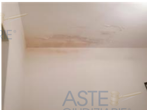
DANNI PROVOCATI DALLE INFILTRAZIONI
