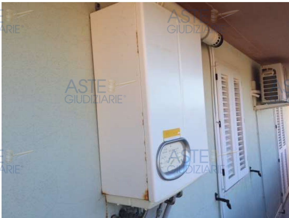
Vista della caldaia per la produzione di acqua calda sanitaria
