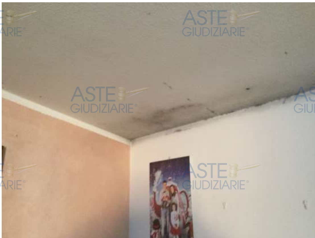
Vista dell'umidità nel soffitto della camera
