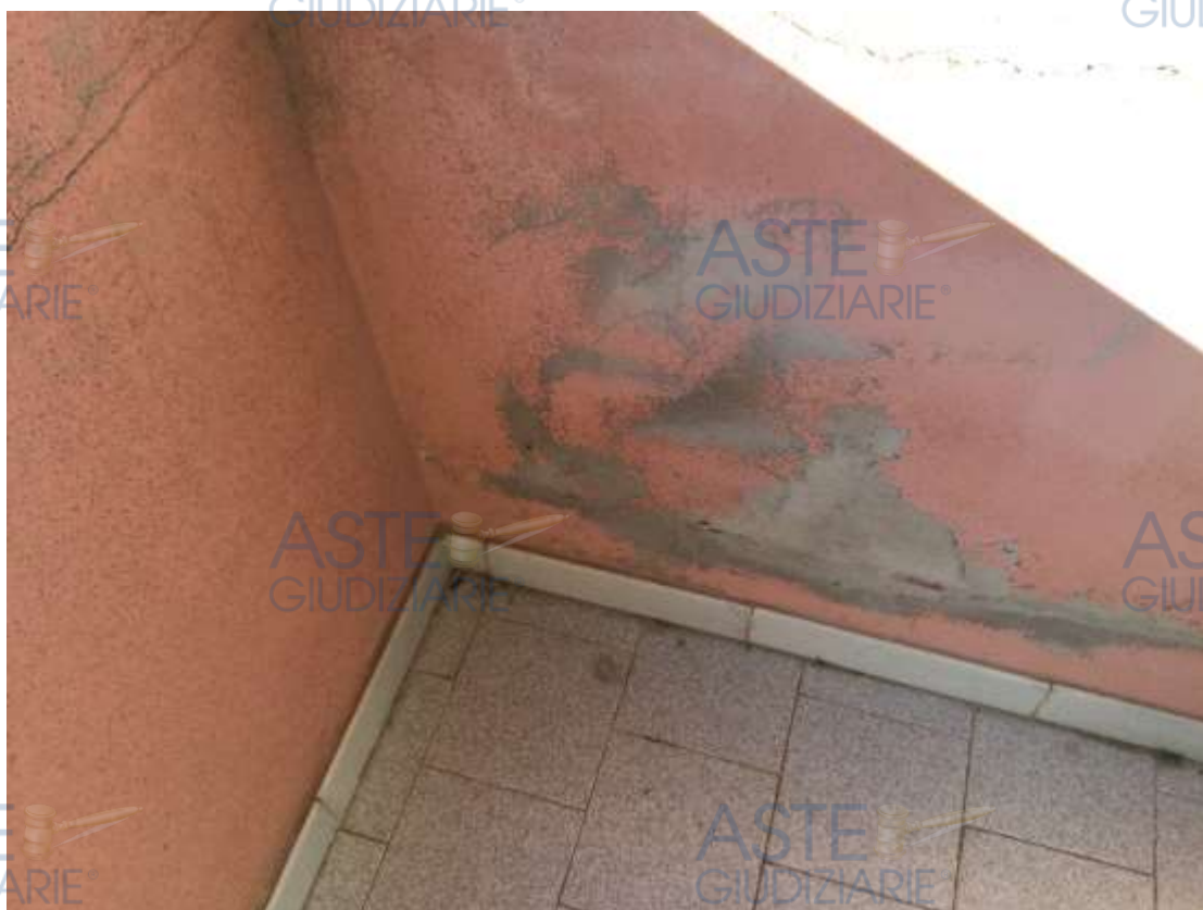
Vista dell'umidità presente nella terrazza
