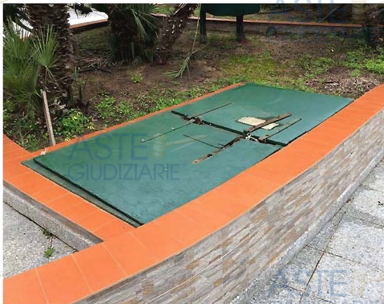
Foto 043 - Locale impianti filtraggio piscina
