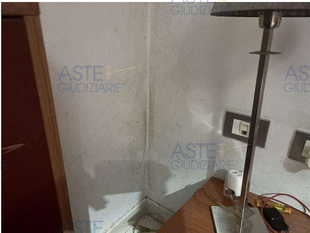
Foto n.25. Via Filippo Turati n.87- Quartu Sant'Elena. Vano letto. Tracce di muffe.
