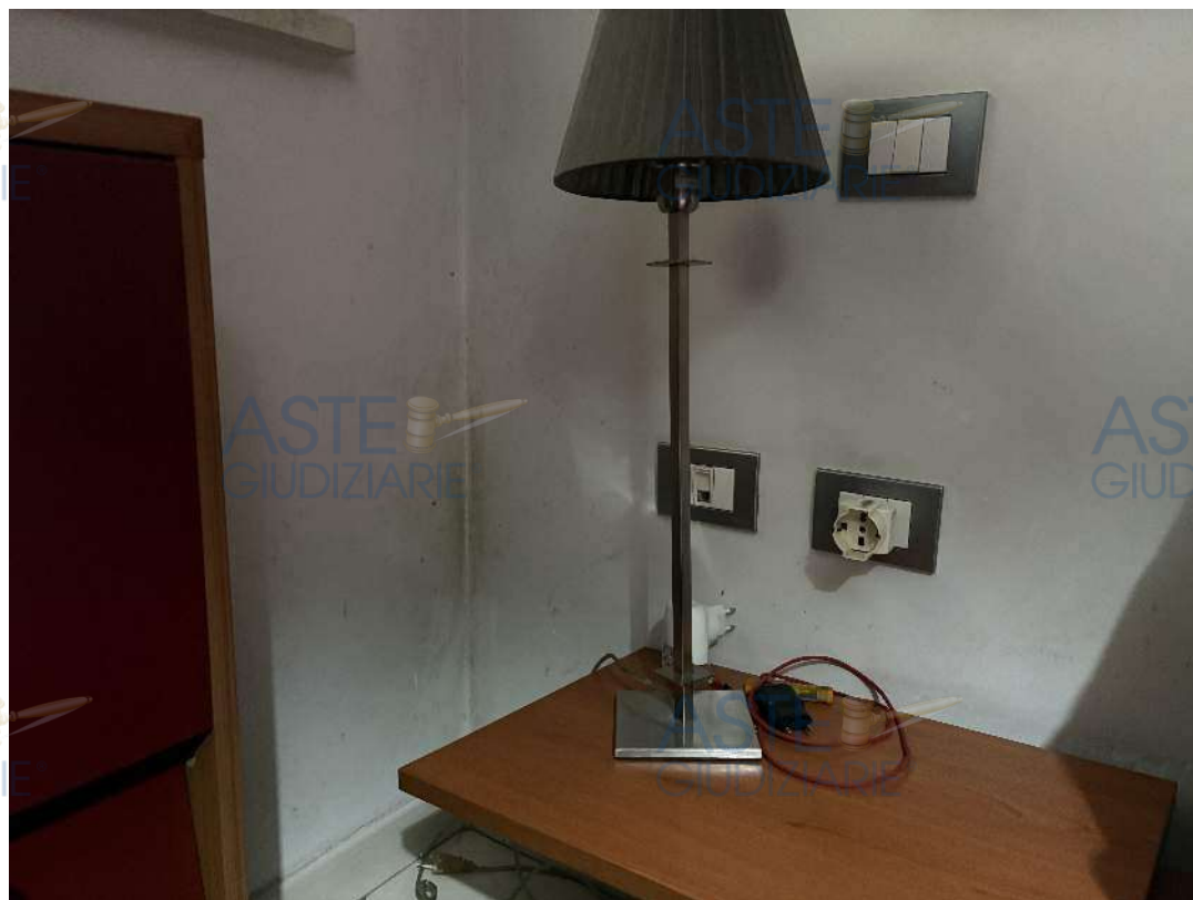
Foto n.26. Via Filippo Turati n.87- Quartu Sant'Elena. Vano letto. Tracce di muffe.
