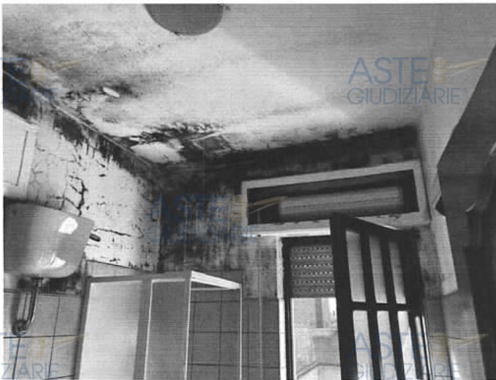
Foto 13: Presenza di muffe dovute alle infiltrazioni al piano primo (26/09/2023)
