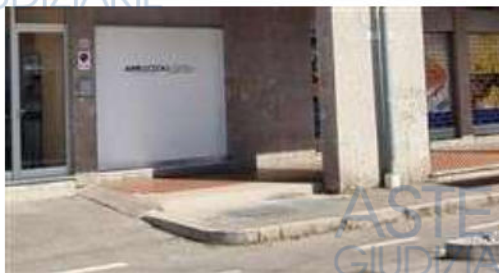
botola accesso cabina Enel interrata
