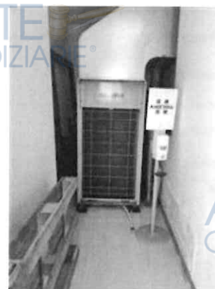
vano tecnico del sub. 540 (imp. ventilazione)
