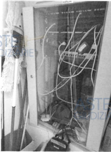
particolare vano tecnico del sub. 541 (ubicazione server)
