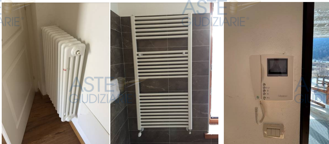
Figura 15: Impianti in dotazione all'abitazione
