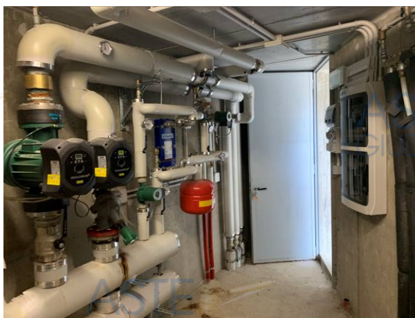
Figura 14: Centrale termica condominiale
