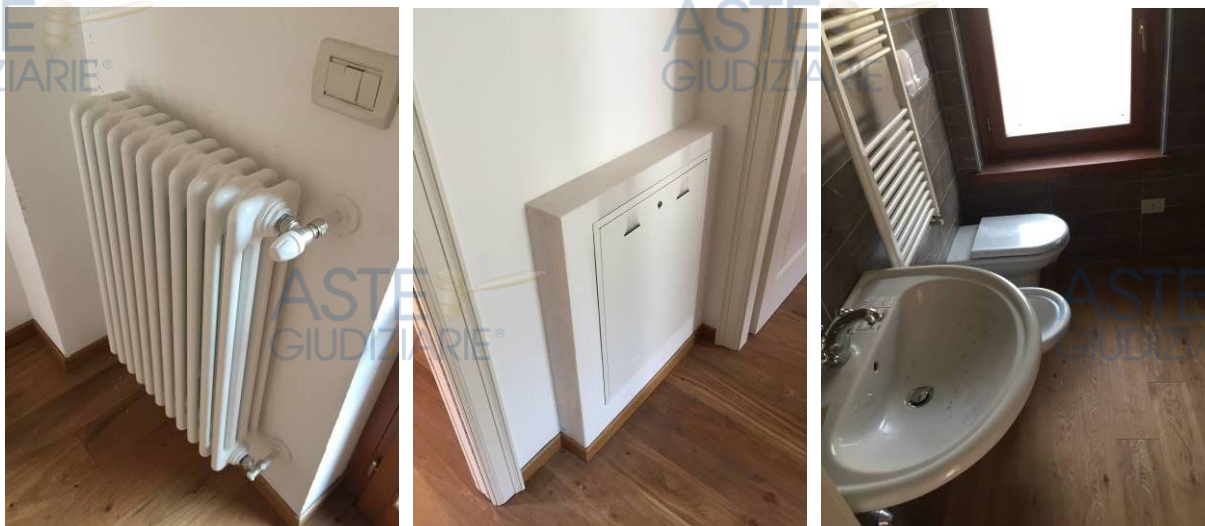
Figura 19: Impianto riscaldamento abitazione piano primo
