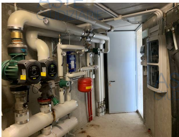
Figura 18: Centrale termica condominiale
