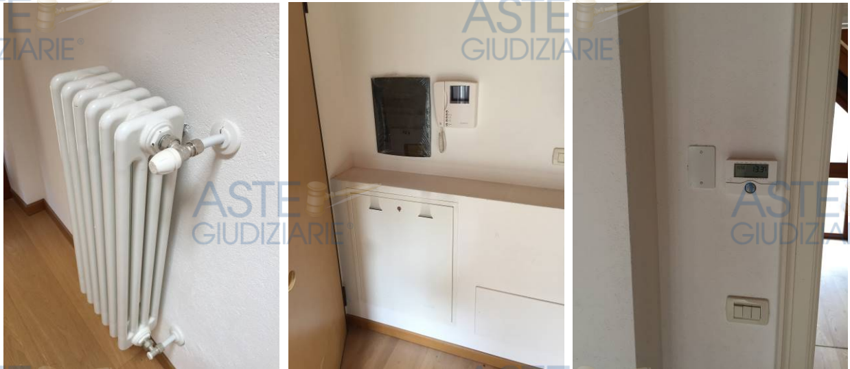
Figura 15: Centrale termica condominiale e impianto riscaldamento abitazione
