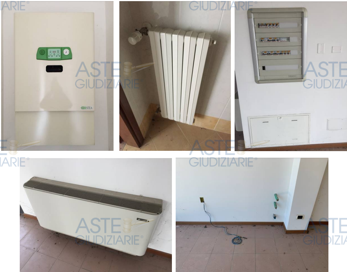
Figura 10: Impianti in dotazione all'unità terziaria
