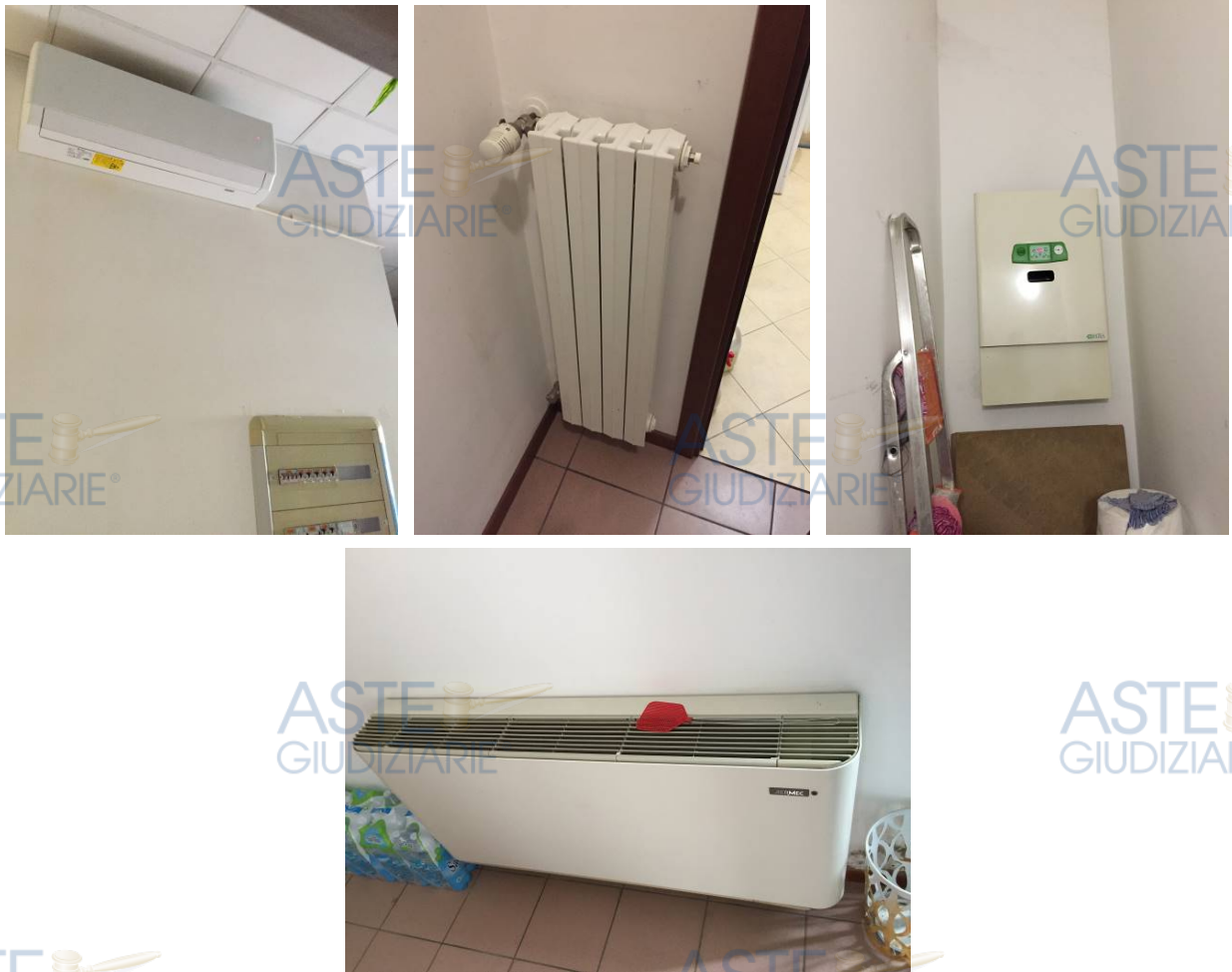
Figura 10: Impianti in dotazione all'unità commerciale
