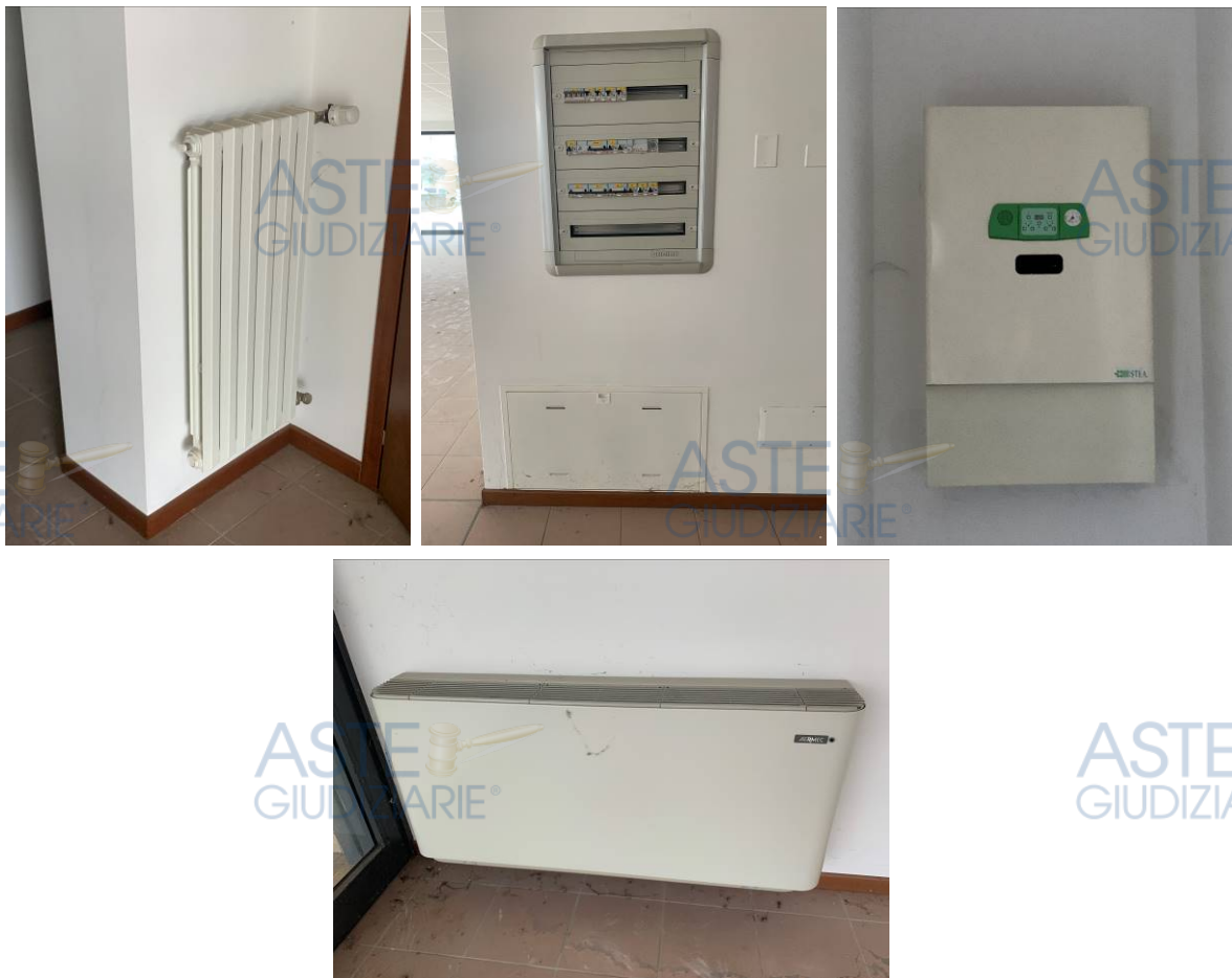
Figura 10: Impianti in dotazione all'unità terziaria
