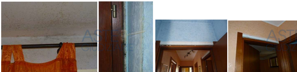
Fig.30,31,32 e 33 – Muffe diffuse in tutte le stanze livello soffitto e pareti esterne e lateralmente ai serramenti ( ponte termico), n°2 cornici superiori delle porte mancanti.
