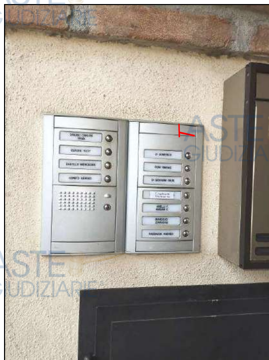
4 - citofono abitazione civ. 35
