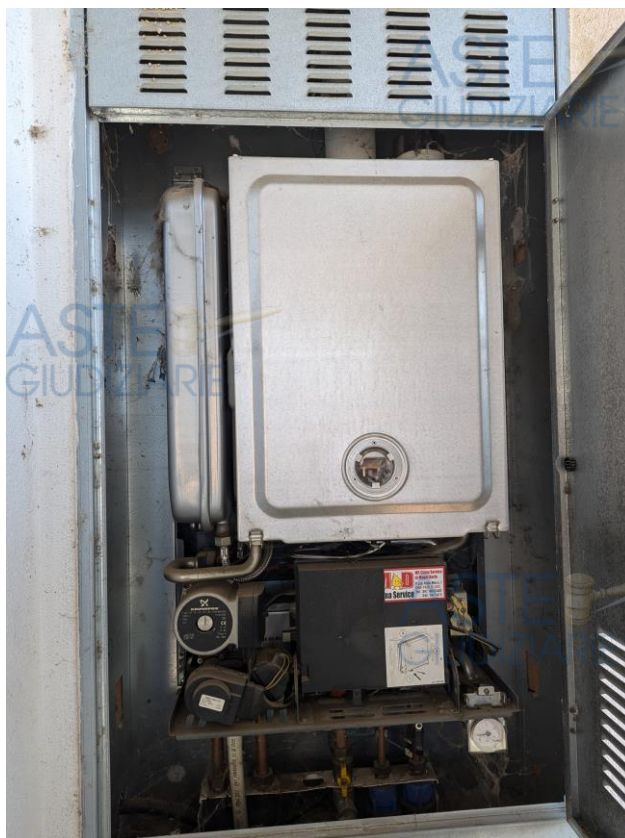
Fotografia n.9 caldaia in nicchia a muro all'ingresso
