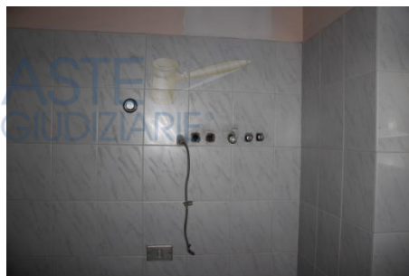
Foto 6 sub 61 La caldaia è stata asportata
