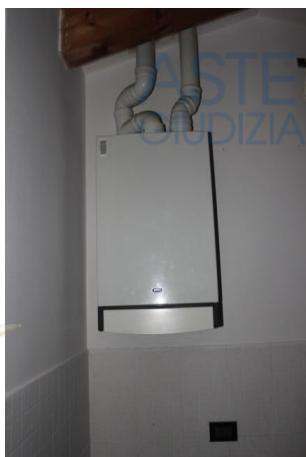
Foto 5 – Caldaia angolo cottura sub. 3
