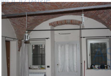
Foto 16 – soffitto soggiorno sub.9
