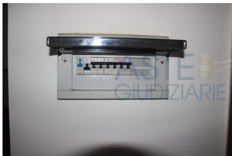
Foto 15 Impianto elettrico a norma
