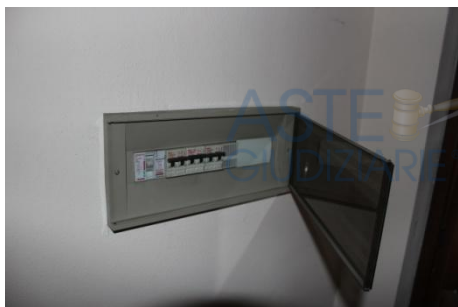
Foto 7 sub 61 Impianto elettrico a norma
