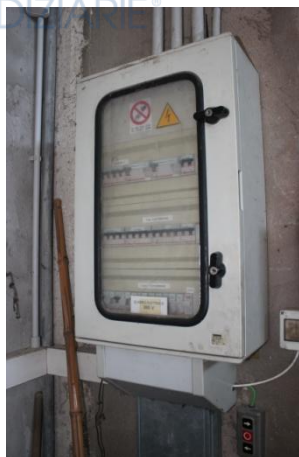
Foto 6 - Particolare quadro elettrico sub. 6
