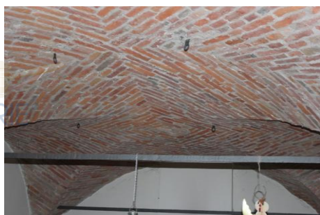
Foto 17 – soffitto soggiorno sub. 9
