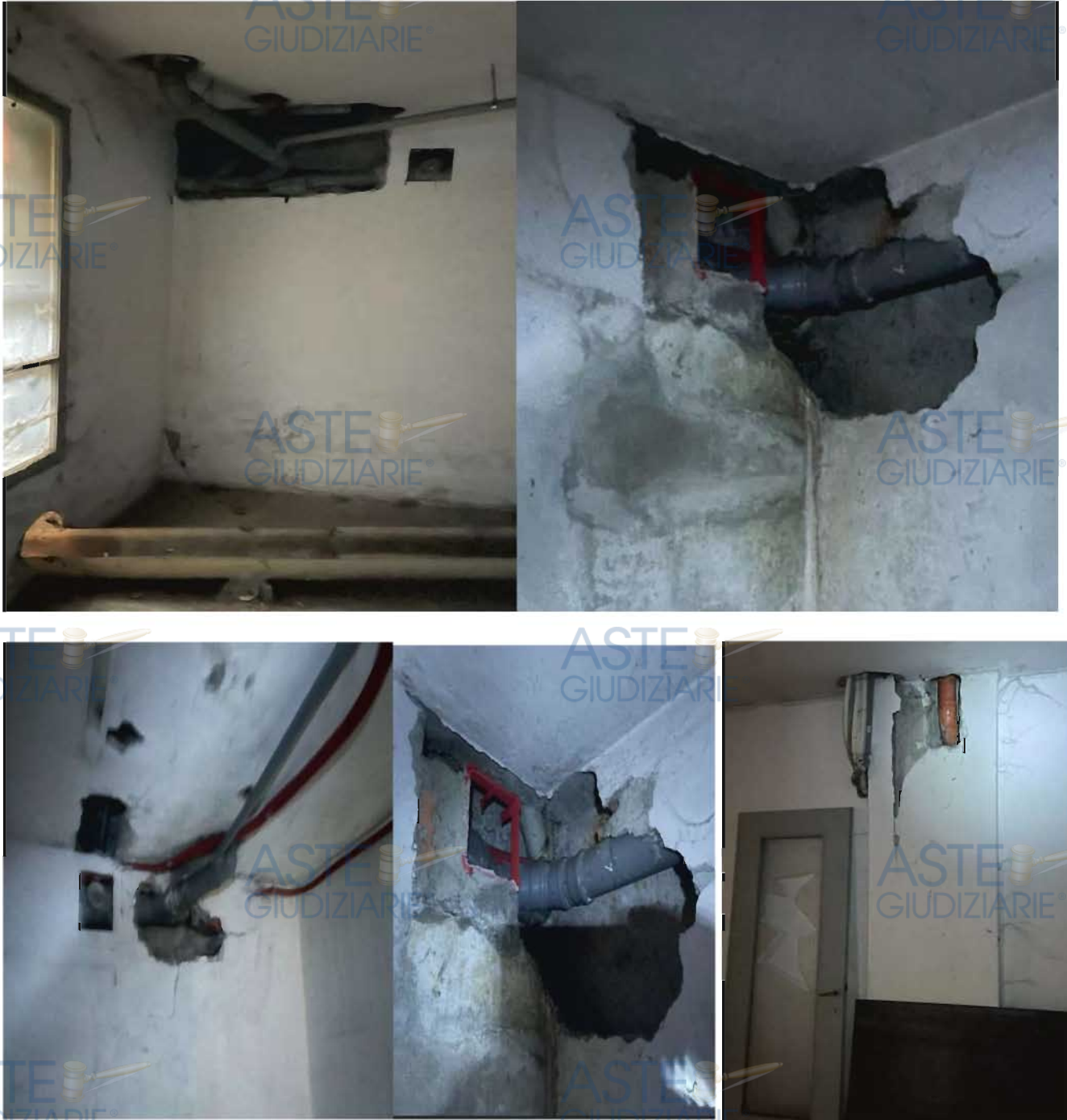
Figura 14: particolare nelle pareti perimetrali in lato nord e est e al piano interrato (Cfr. Allegato 24 Tav,2).
