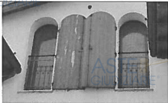
Particolare scuri ammalorati
