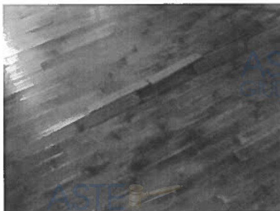
Sottotetto: Danni al pavimento docuti ad infiltrazioni
