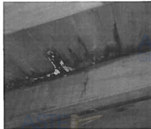
Sottotetto: Ammaloramento intradosso copertura lignea
