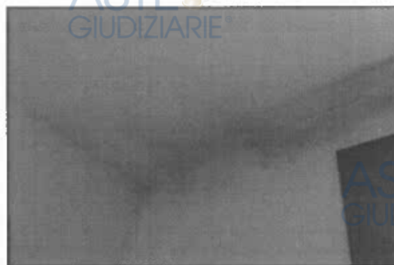
Piano terra: Particolare muffe da condensa
