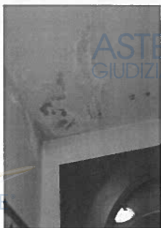
Piano terra: Particolare infiltrazione
