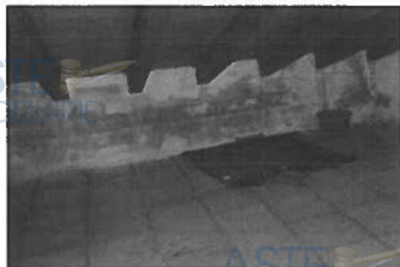
Sottotetto: Particolare infiltrazioni
