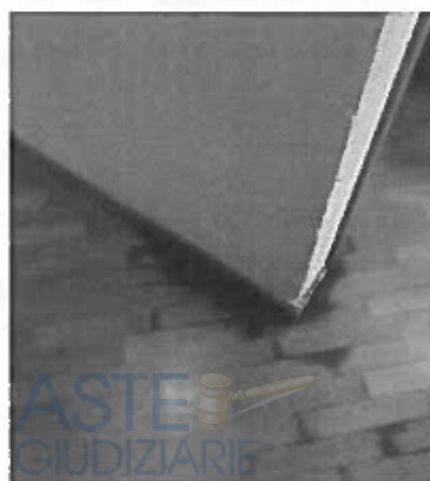
Piano terra: Particolare danni al pavimento dovuti ad infiltrazioni
