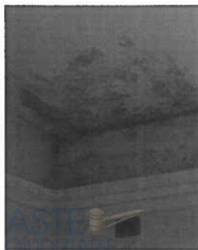
Piano terra: Particolare danno da infiltrazioni
