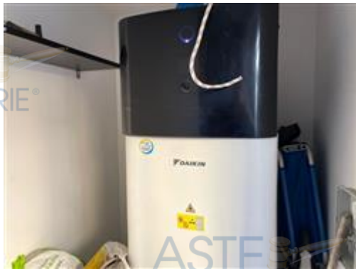
batteria e sistema fotovoltaico Daikin
