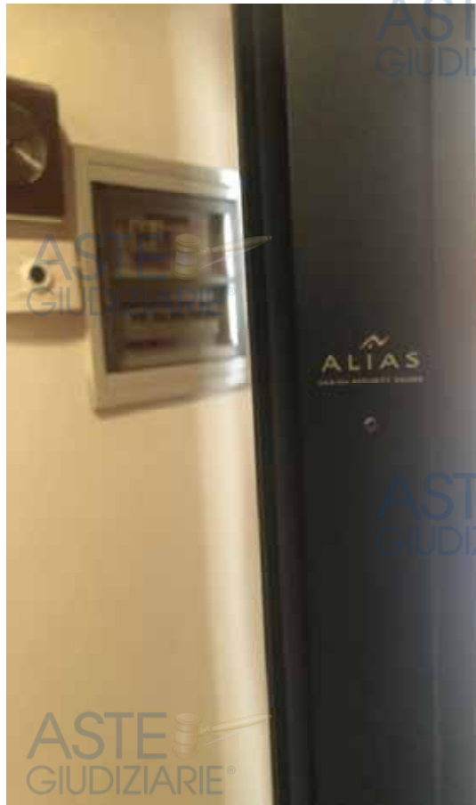
Dettaglio porta d'ingresso e impianti
