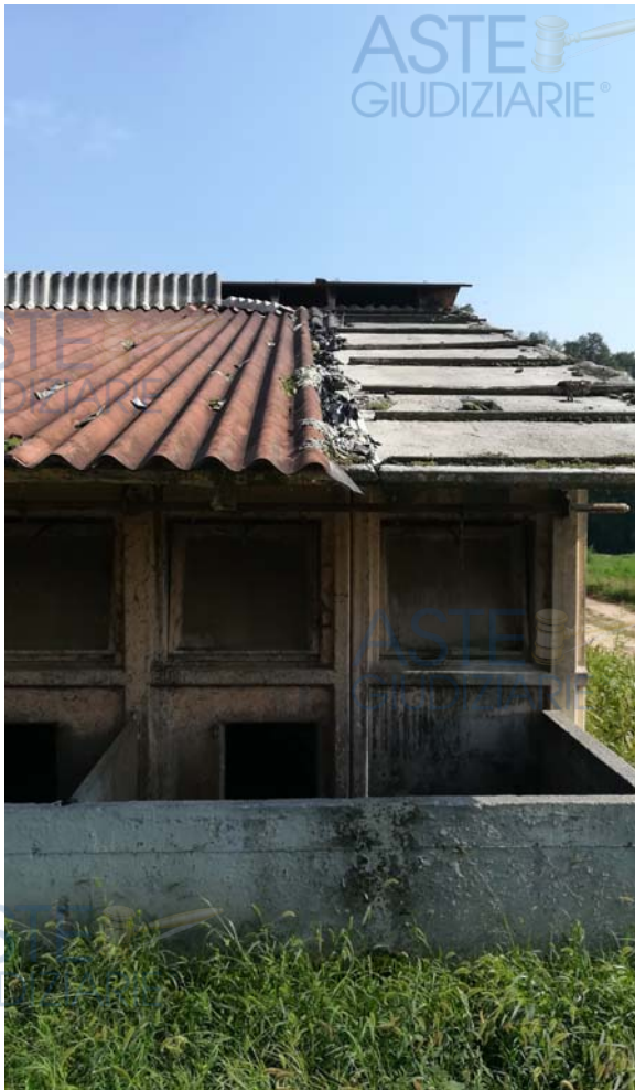
Copertura degradata e ammalorata
