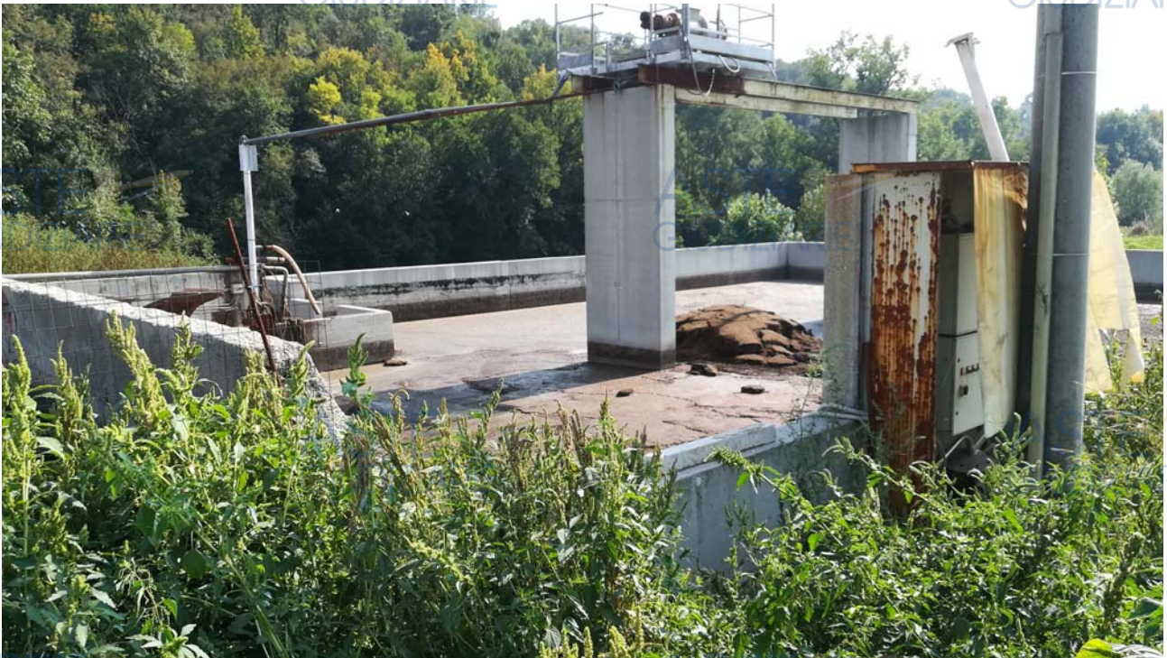
Depuratore in evidente stato di abbandono
