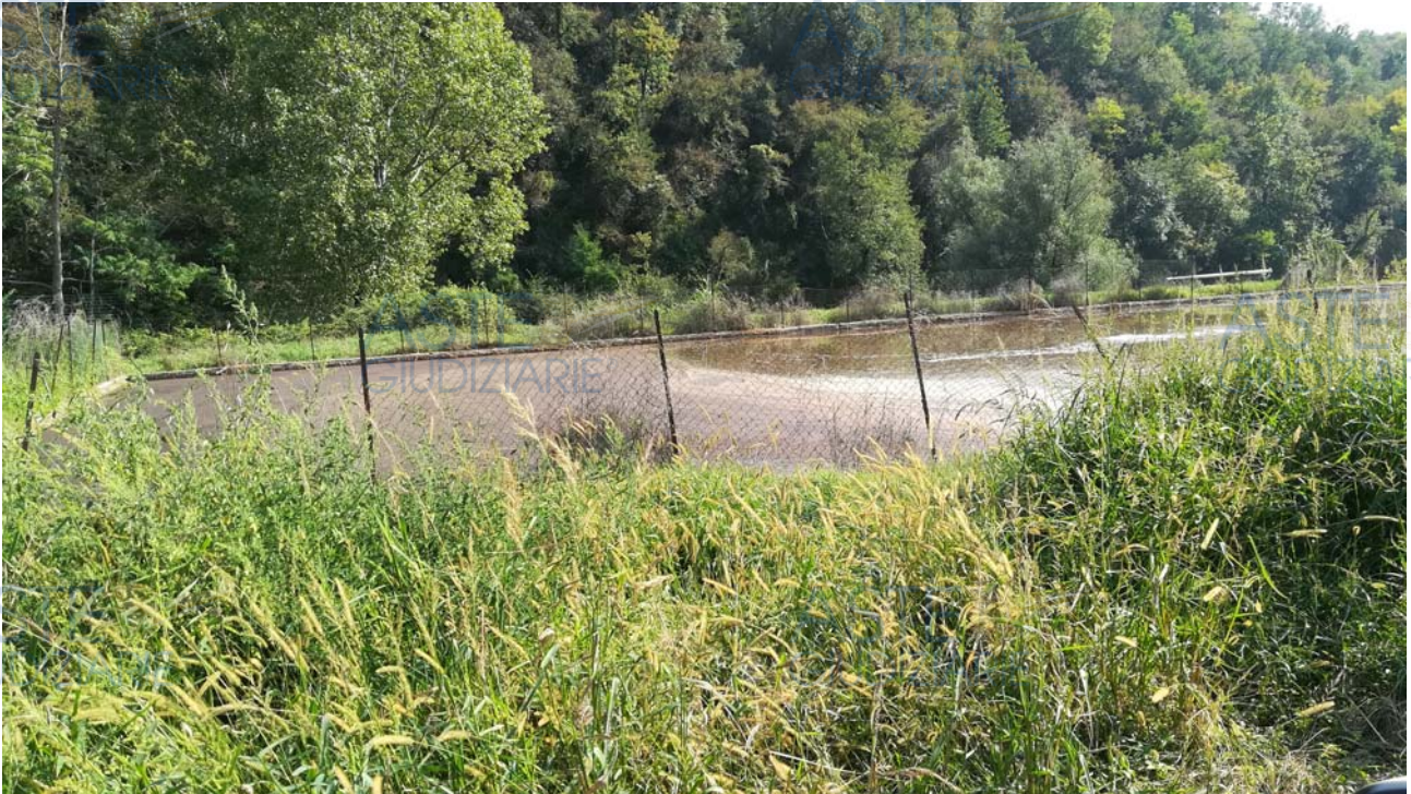
Vasca stoccaggio, sono evidenti i segni di degrado del calcestruzzo sulle giunzioni
