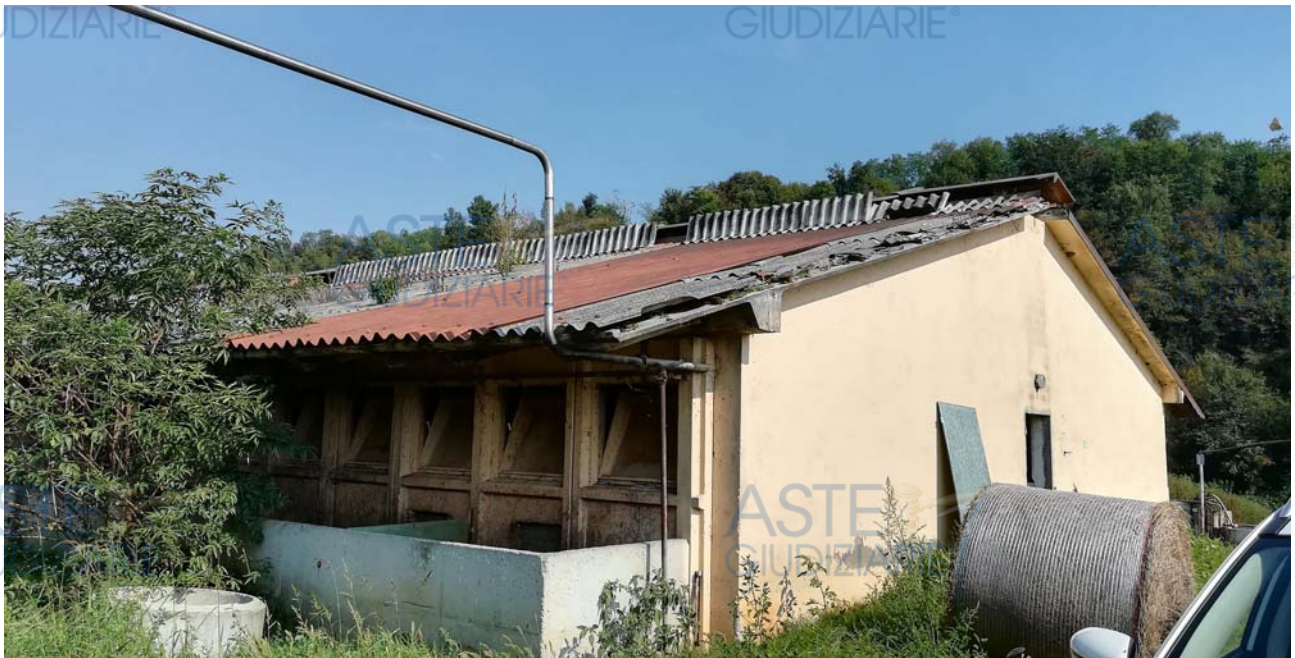
Copertura in amianto cemento deteriorata
