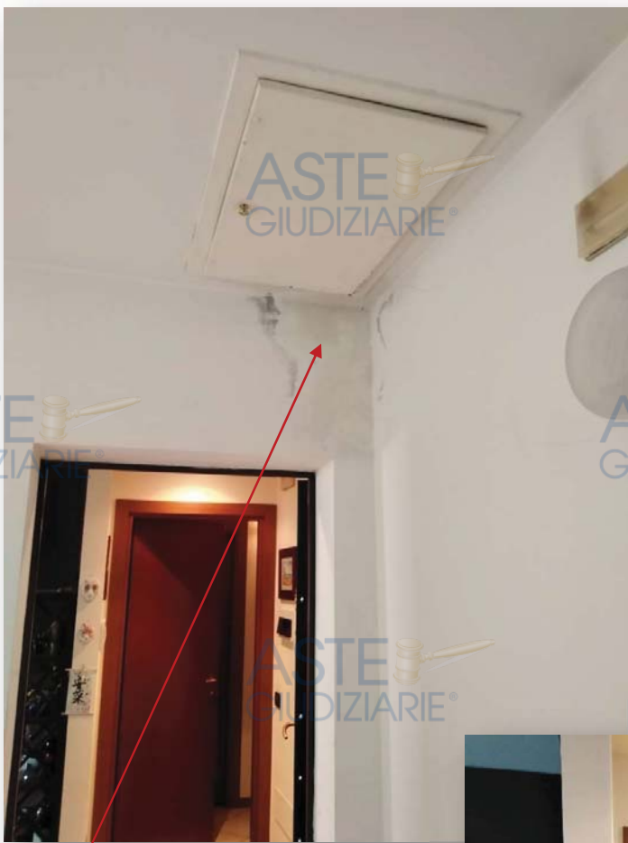
Le infiltrazioni, probabilmente provenienti dalla copertura comune, sulla parete con il portoncino d'ingresso al BENE 1
