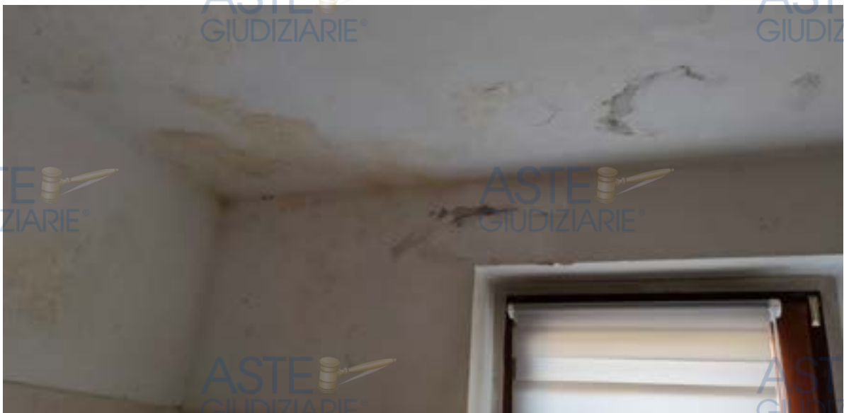
Soffitto bagno Piano Terra – tracce infiltrazioni
