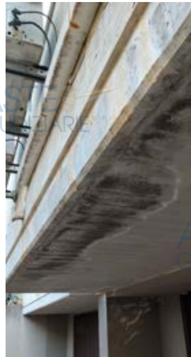
Ammaloramento intadosso balcone
