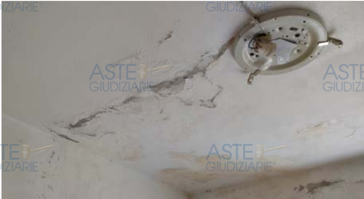
Soffitto bagno Piano Terra – tracce infiltrazioni
