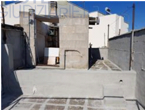
foto del manufatto abusivo sul lastricato solare
