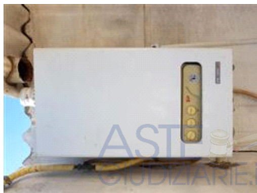
foto caldaia situata nel vano abusivo sul lastricato solare
