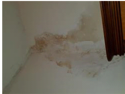
foto interna delle macchie di umidità rivenienti da infiltrazioni di acqua
