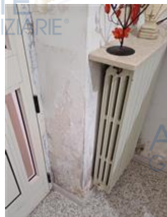
Foto n.12 - - vista interna delle macchie di umidità e del deterioramento dell'intonaco e della pittura sulle pareti
