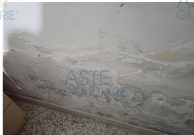
Foto n. 11 - vista interna delle macchie di umidità e del deterioramento dell'intonaco e della pittura sulle pareti
