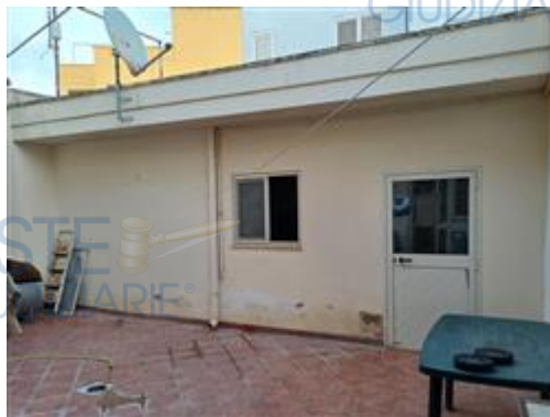
Foto n. 5 - vista esterna del locale deposito abusivo insistente sul cortile
