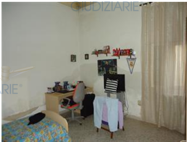
Foto n.10 - vista interna del vano letto e delle macchie di umidità di risalita sulle pareti
