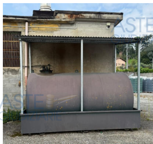
ID. 09 – CISTERNA LIQUIDI CON TETTOIA
