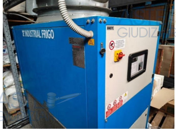
Id 37 – Gruppo di refrigerazione
