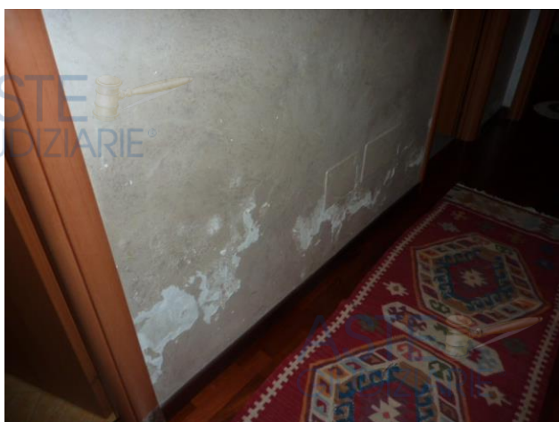
Umidità presente su parete divisoria disimpegno/bagno
