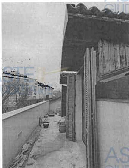
Terrazzo a pozzo lato Nord-Ovest: lavori non conclusi e non autorizzati
