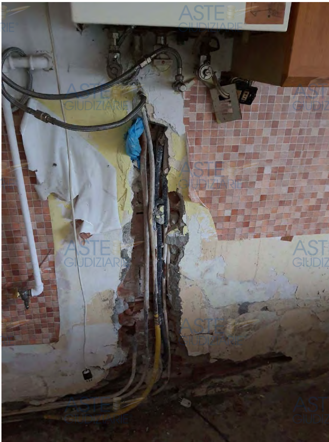
RILIEVO INTERNO ABITAZIONE - DETTAGLI - 1° P. – Foto 58. Rilievo dei danni alle tubazioni derivate dalla caldaia interna.
