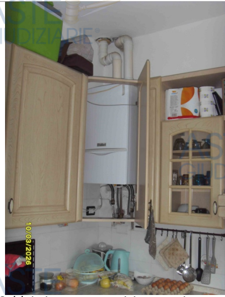
Caldaia interna – posizione cucina
