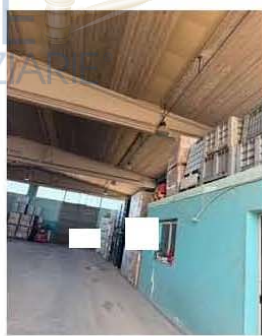
interno zona lavorazione
