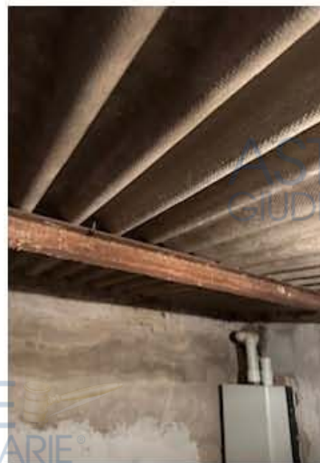
copertura amianto vano tecnico
