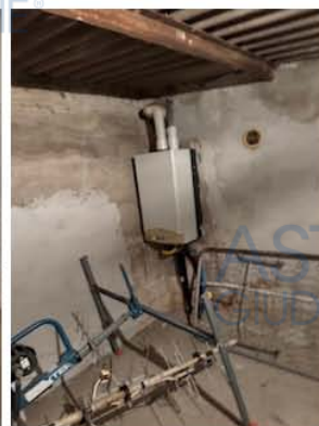
caldaia in vano tecnico
