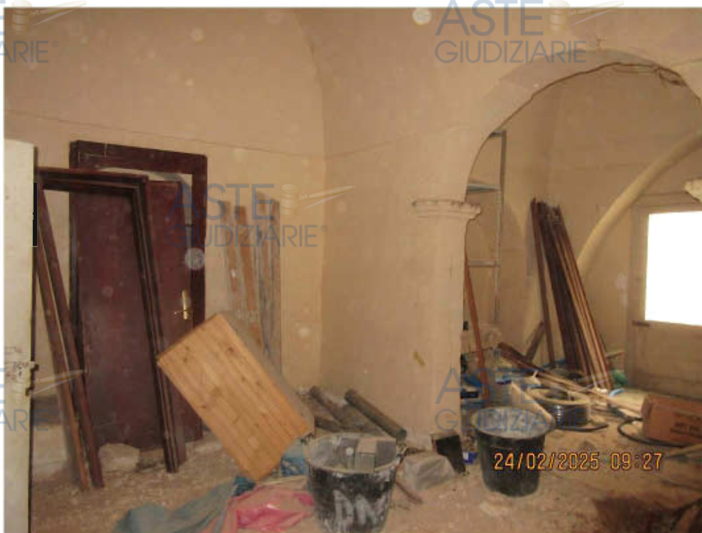
Foto n.23 ambiente n.7 in scadenti condizioni
