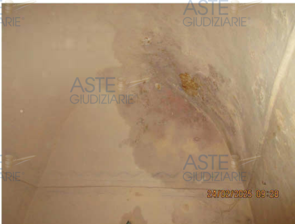
Foto n.25 Evidenti tracce di fenomeni di infiltrazioni delle acque meteoriche
