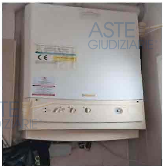
Foto n. 22 Bagno - Caldaia riscaldamento e acqua calda
