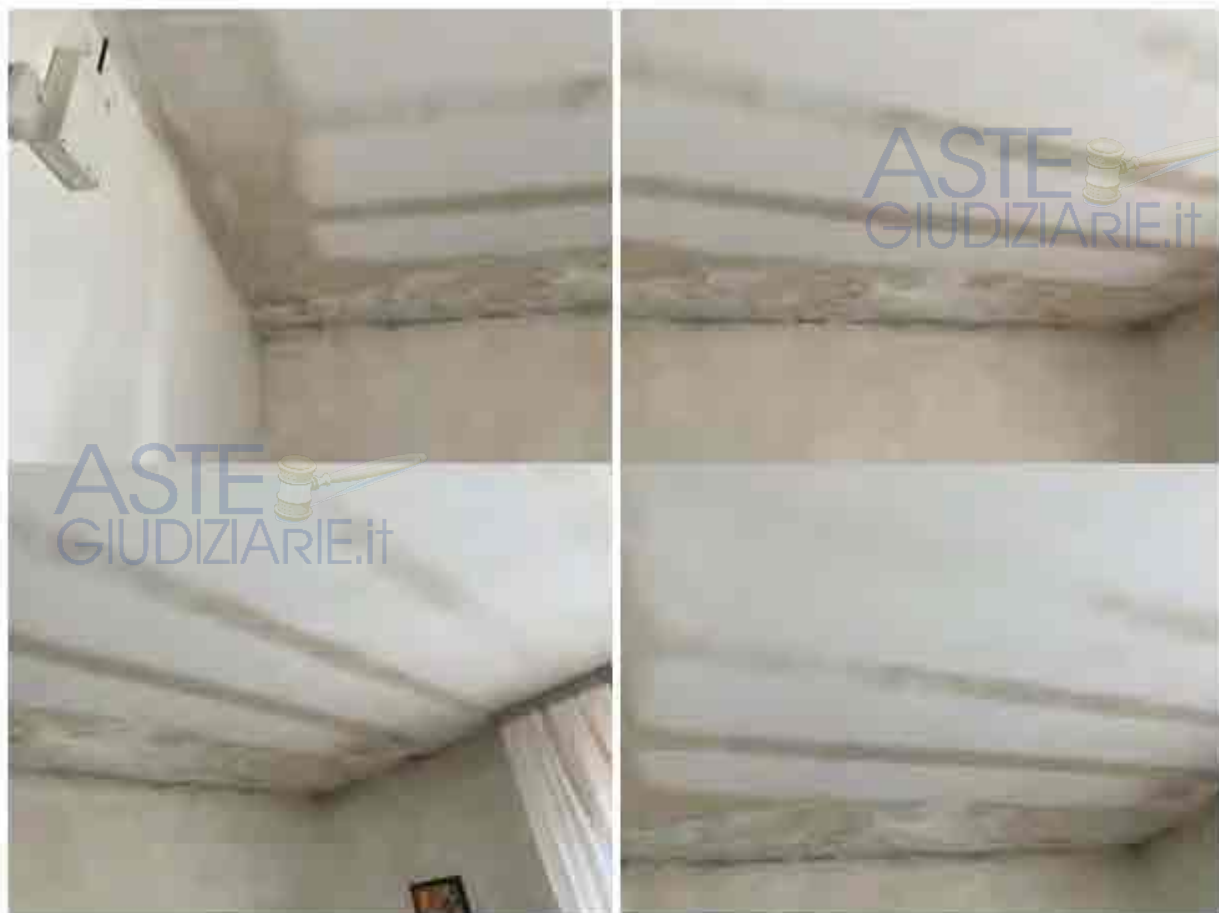
Vista camera da letto nella quale si rileva presenza di condensa
