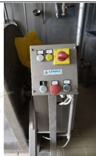
Foto 4 - Quadro di Comando
