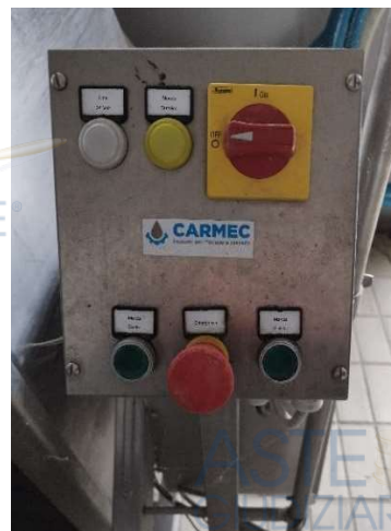
Foto 2 - Quadro di Comando
