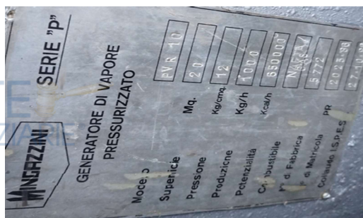
Foto 93- Etichetta caldaia C.T. n 1
