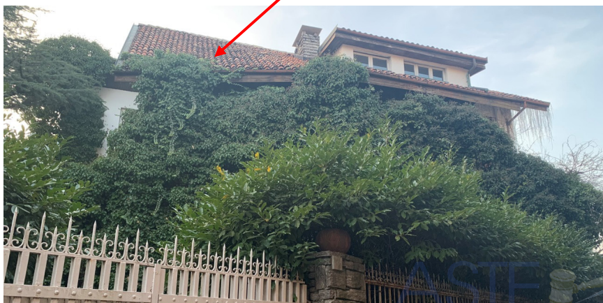
Foto 5a: Vista del tetto lato via Camagni con localizzazione della porzione danneggiata
