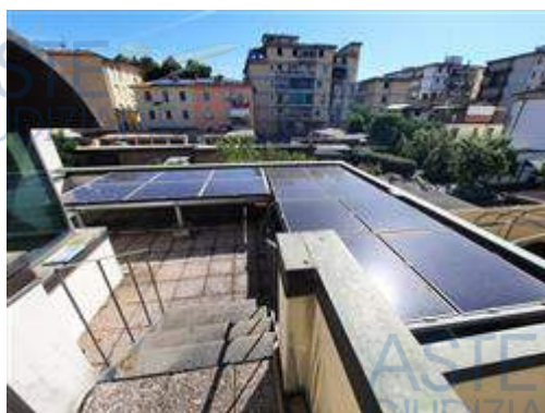
Vista parte impianto fotovoltaico su lastrico solare
