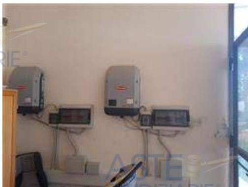
Vista quadri impianto fotovoltaico
