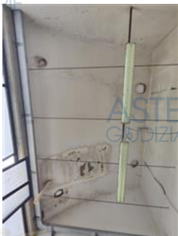
Infiltrazioni dal soffitto dell'opificio
