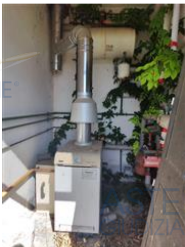
impianto termico abitazione /uffici in stato di abbandono e coperto da vegetazione
