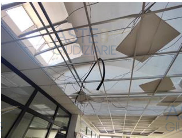
Plafonature Opificio crollate
