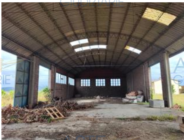
Magazzino in stato di abbandono
