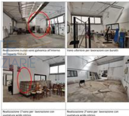
FOTO DIFFORMITA' PIANO TERRA
