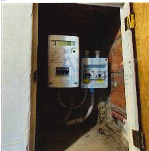
Contatore elettrico posto dentro i locali del ristorante a piano terra
