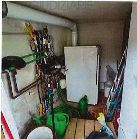
Impianto riscaldamento posto a piano terra nel locale centrale termica con accesso esterno
