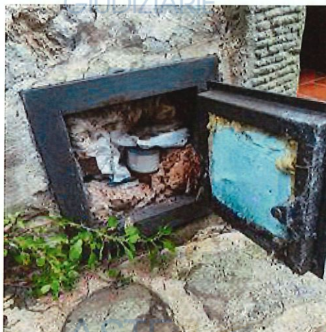
Contatore acqua installato su nicchia presente nel fabbricato prospiciente
