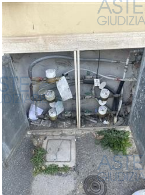
vano contatori attuale
