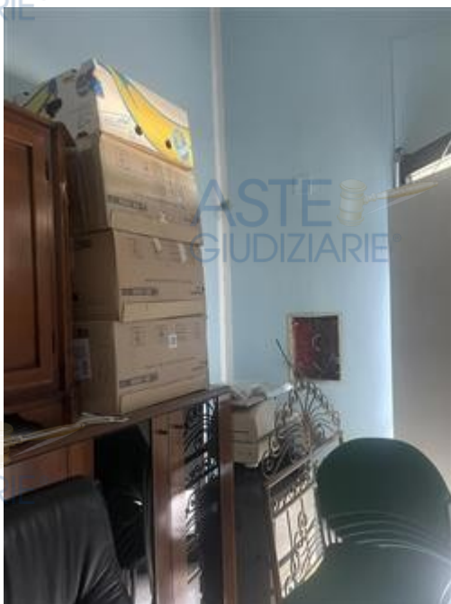
posizione attuale del quadro elettrico
