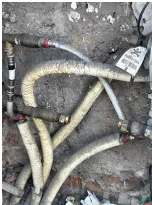
particolare del vano contatori che riguarda il Lotto 2
