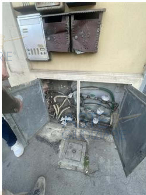
attuale vano contatori
