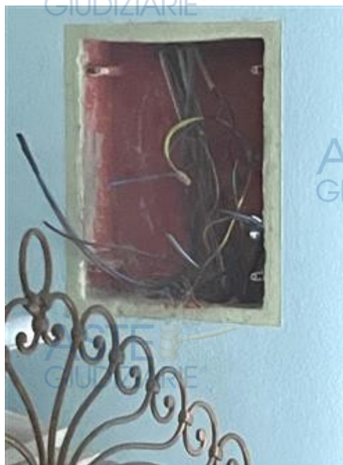
quadro elettrico completamente mancante
