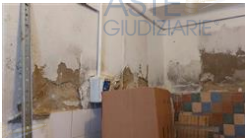
Umidità piano terra
