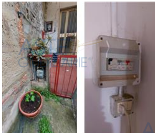
Contatori esterni / Quadro elettrico piano terra
