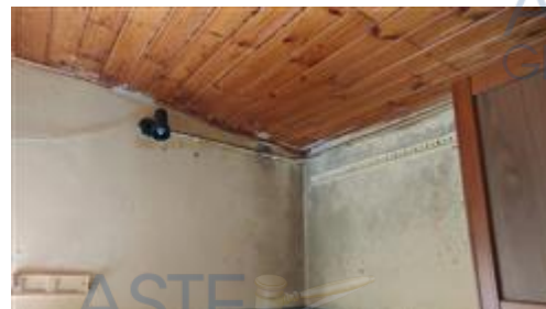
Condensa piano primo
