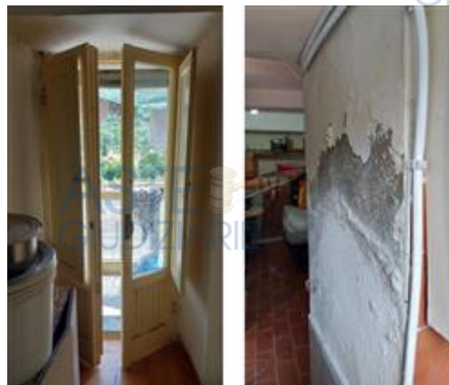
Infisso piano rialzato / Umidità piano terra
