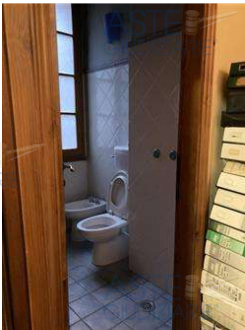
VISTA INTERNA ALL'UNITA'
