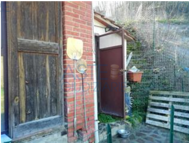
vano tecnico caldaia, in aderenza al fabbricato
