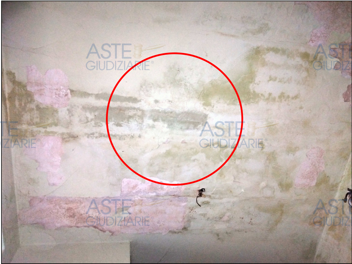
Foto 3 – solaio appartamento al piano terreno con nuove infiltrazioni dopo aver gettato acqua nella doccia.
