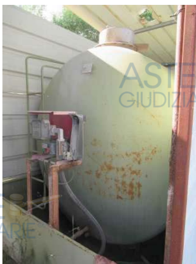
Foto 35 – Pompa travaso nafta
