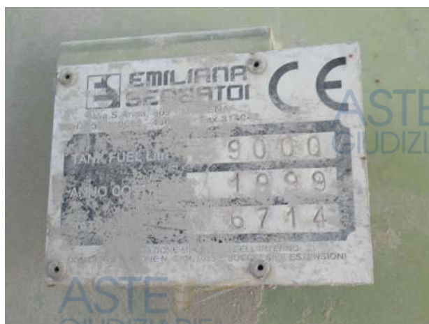
Foto 36 – Pompa travaso nafta - Matricola
