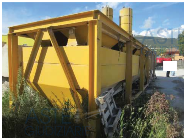
Foto 16 Impianto di calcestruzzo
