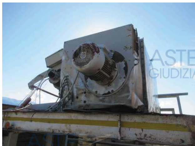
Foto 22 – Impianto di calcestruzzo -motore
