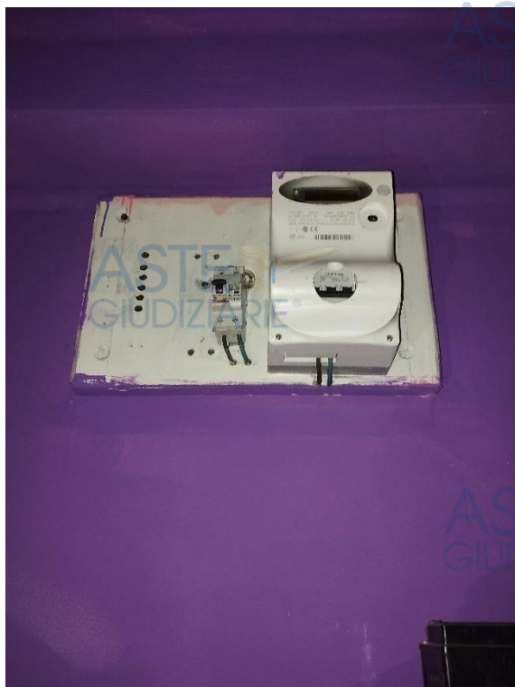
contatore energia elettrica con sezionatore
